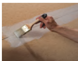
Déposer le primer PAVAPRIM sur les panneaux avec la bouteille verseuse et l'étaler avec un pinceau ou un rouleau
